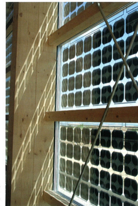
Die in der Glasfassade der Mensa integrierten Module spenden im Sommer Schatten und schützen vor Überhitzung des Raumes.
